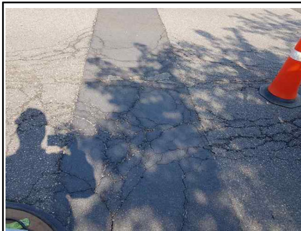
내용 신덕은~문산 #1 아스콘망상균열
