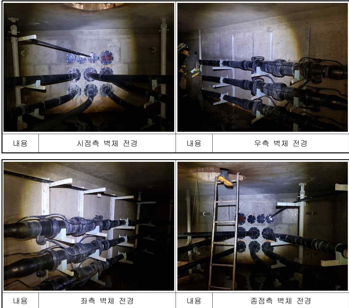
【사진 5.9】 신덕은~문산 #3 전경
