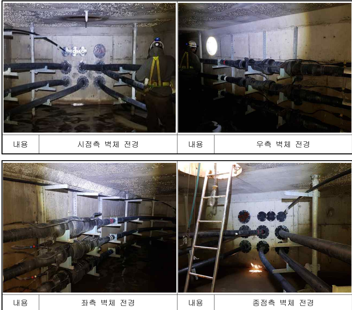
【사진 5.13】 신덕은~문산 #4 전경
