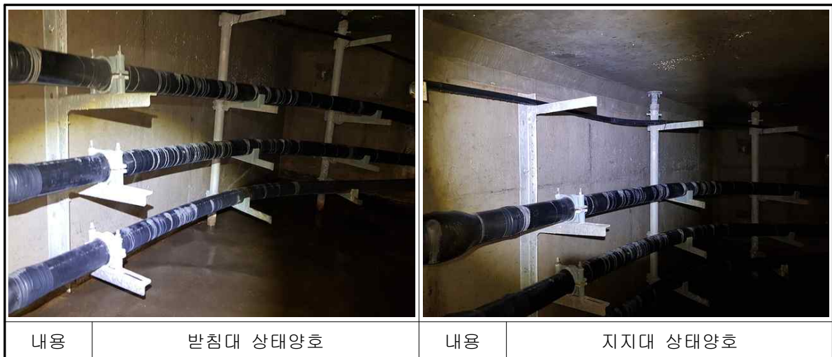
【사진 5.12】 부속 및 부대설비 현황
