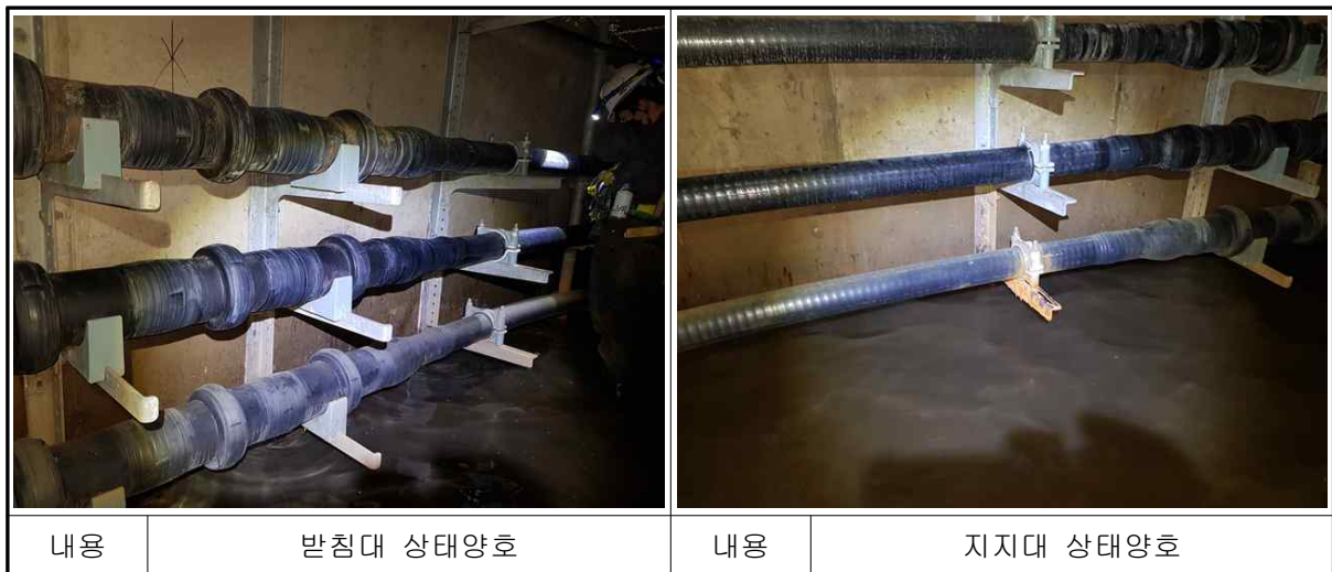
【사진 5.8】 부속 및 부대설비 현황
