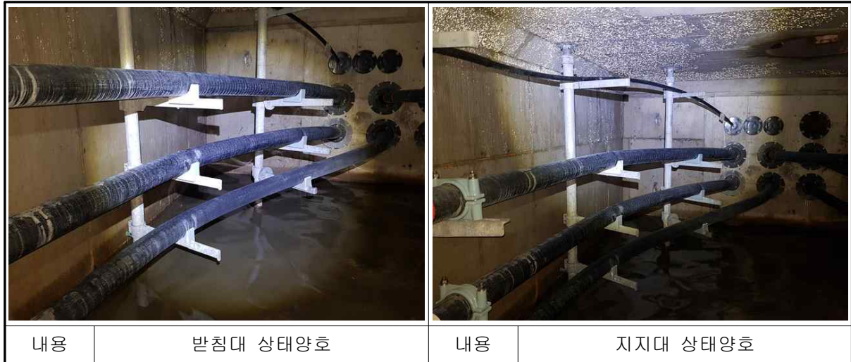
【사진 5.16】 부속 및 부대설비 현황
