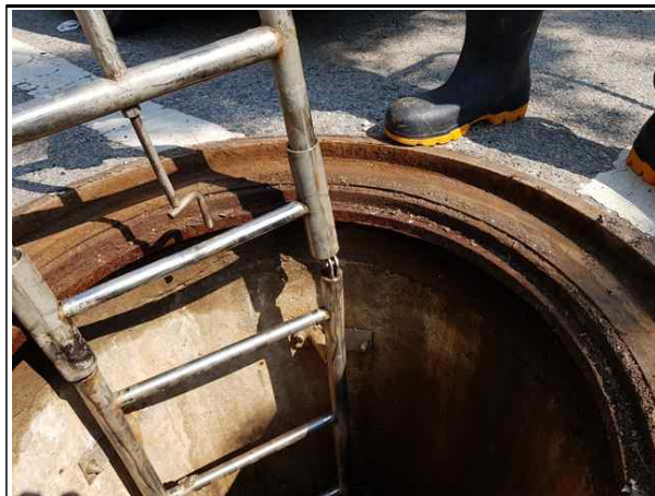
내용 신덕은~문산 #3 안전손잡이볼트탈락
