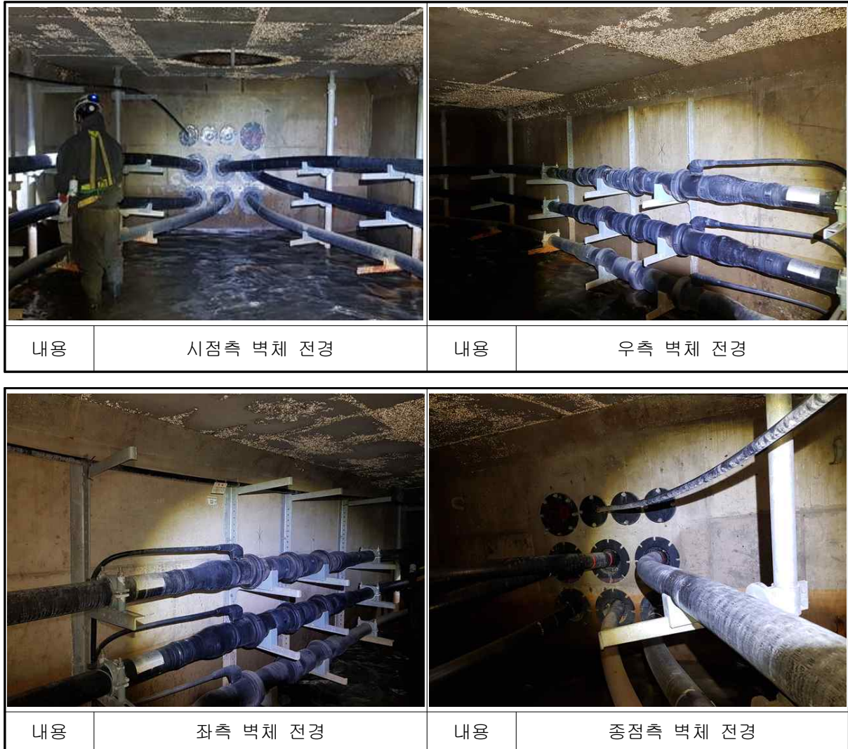
【사진 5.5】 신덕은~문산 #2 전경
