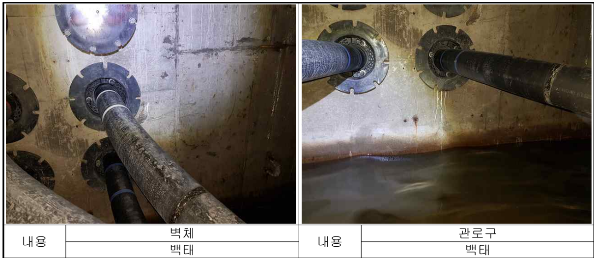
【사진 5.14】 맨홀 내부 주요 손상
